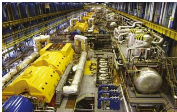
Az erőmű turbinacsarnoka
