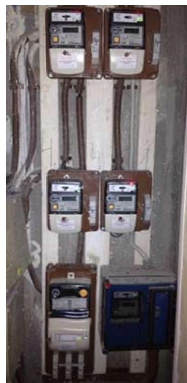
3. ábra Hat lakás okos mérővel felszerelve (PLC kommunikációval)
