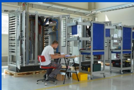
ALSTOM Riyadh Metro 330 kV GIS LVCC
