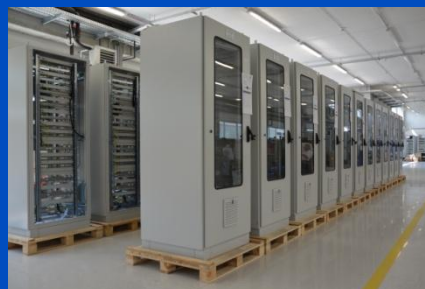
ALSTOM Tadjikistan SS Telecom
