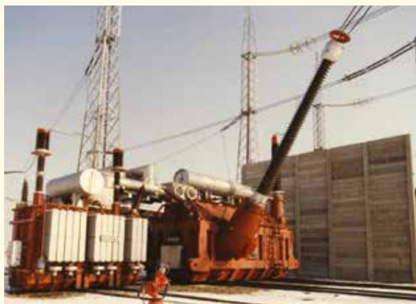
2. ábra Az Albertirsai 750/400 kV-os állomás Ganz Villamossági Művek által gyártott 1100 MVA háromfázisú teljesítményű 750/400/15 kV-os transzformátorának fő- és szabályozó fázisegysége
