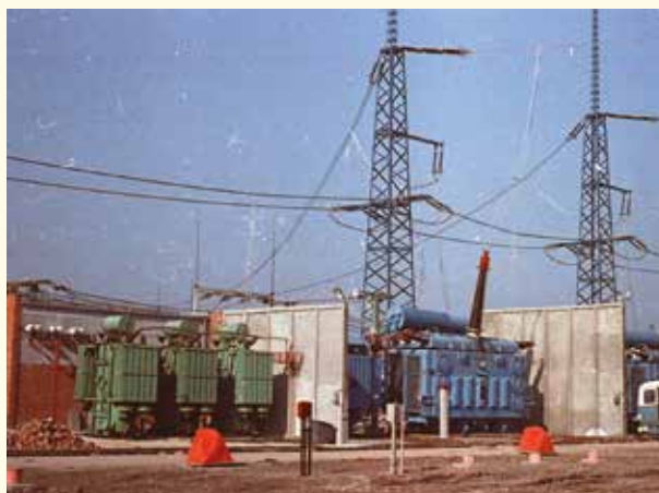
1. ábra 1968: a Ganz Villamossági Művek által gyártott első 400/120/18 kV-os, 360 MVA teljesítményű transzformátor a Gödi 400/220/120 kV-os állomáson. (Baloldalt a 18 kV-os, 50 Mvar-os söntfjót)
