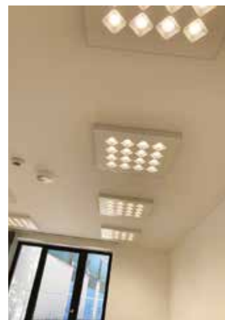
9. ábra Irodavilágítás korszerű LED-világítótesttel
